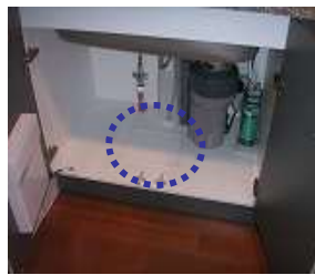
キッチンシンク下の点検口
